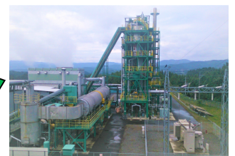
バイオマス発電所
